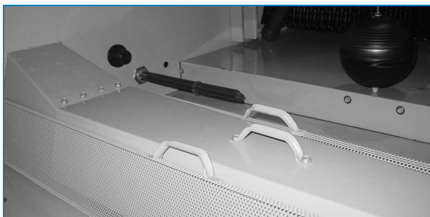
Balsa de agua fría y filtros de la balsa
