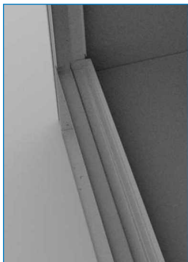
Gouttière de recueil de l'eau
