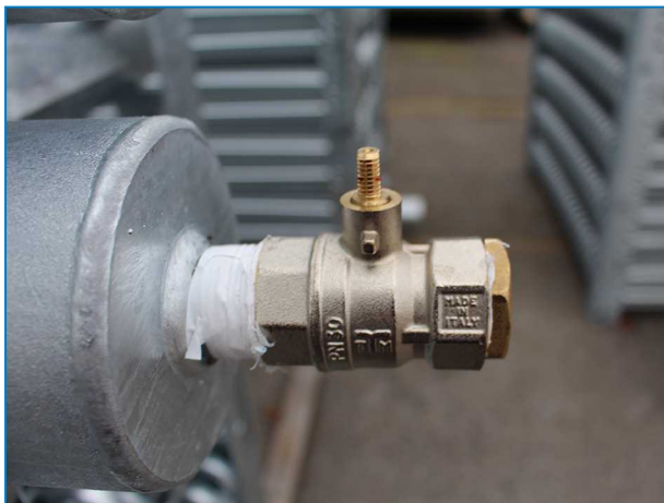
Conexión de batería superior con válvula de liberación de presión en condensadores.
