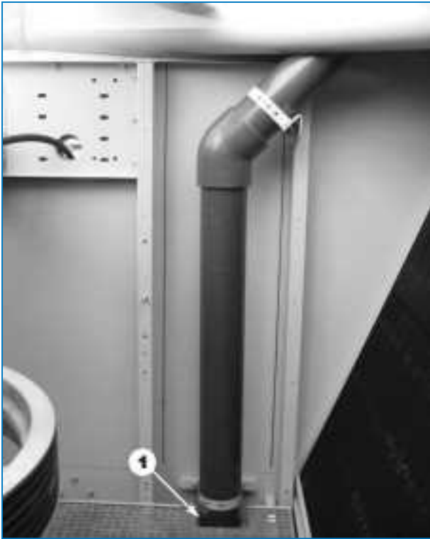
Pumpenrohrleitung Plenumteil innen
