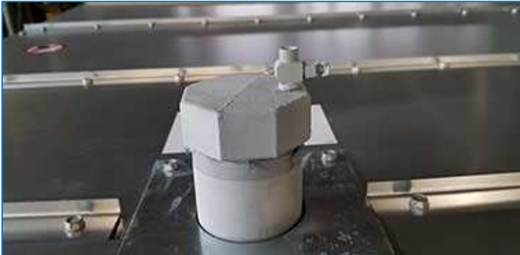
Gängad spolekoppling på termisk isförvaring
